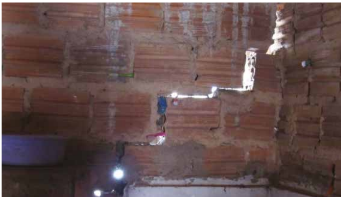
Imagen 79: Grietas en una de las viviendas ubicada en el entorno de la EFC, ocurridas después del inicio de las obras de duplicación
