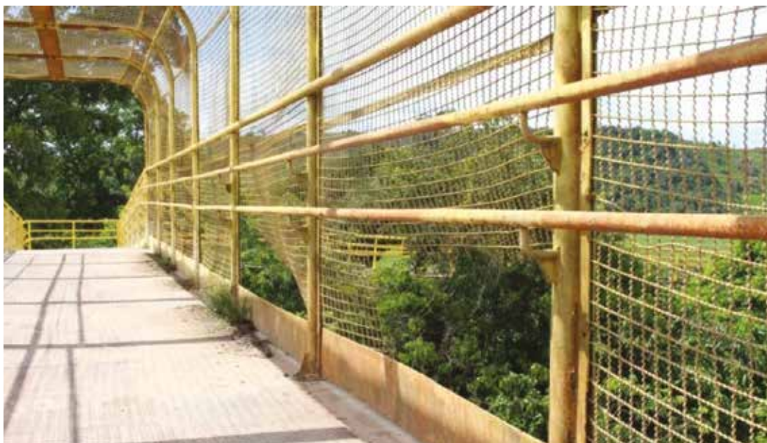
Imagen 81: Puente ubicado en Vila Concórdia. Rejilla de protección del puente en condiciones precarias.
