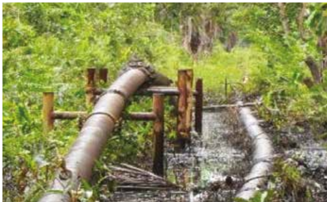
Imagen 65: Ductos en pésimas condiciones, que demuestran como ejercen la actividad petrolera.
